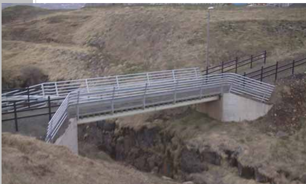
Reiðbrú yfir Glerá á Akureyri. Trektlaga öryggisgrindum hefur verið bætt við brúarhandriðið beggja megin, sjá bls. 27. Vegfarandinn þarf að finna til öryggis hvar sem hann ferðast.
